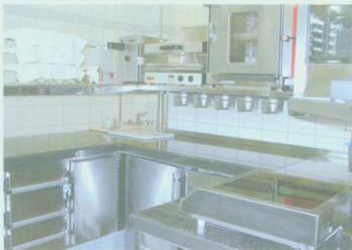
Patissier und Gardemanger teilen sich einen Arbeitsbereich
