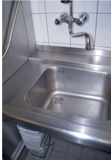
Am Becken: Hebel-Überlaufventil
